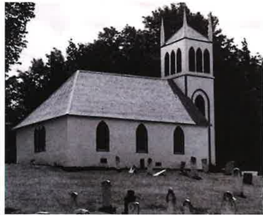
Église « Christ Church of Springbrook » - Vue arrière du toit après la restauration de 1985-1986 (Photo de Marc Hardy)
